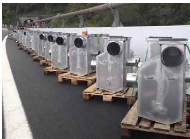
Pozzetti tagliafiamma in acciaio inox installati nella galleria del Cucchero
